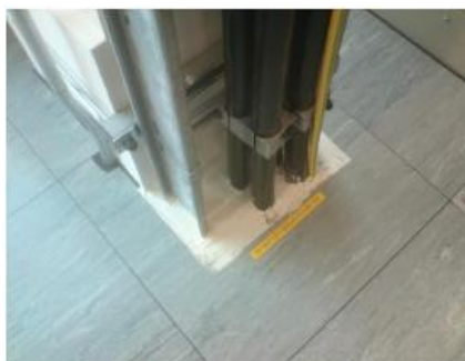
Les ouvertures dans le plancher technique ont été bouchées
