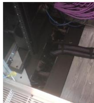
sauf au niveau des passages de câbles
